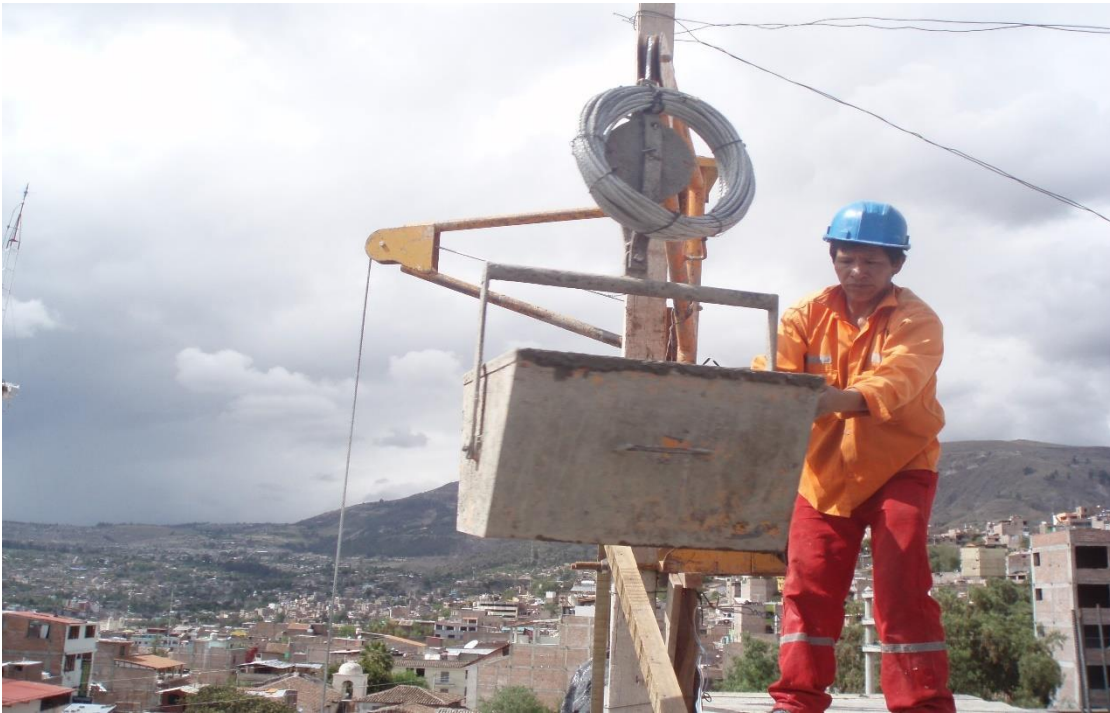
FOTO 8: SIN ARNÉS EN LA RECEPCIÓN DE CONCRETO CON WINCHE ELÉCTRICA A 12M DE ALTURA.
