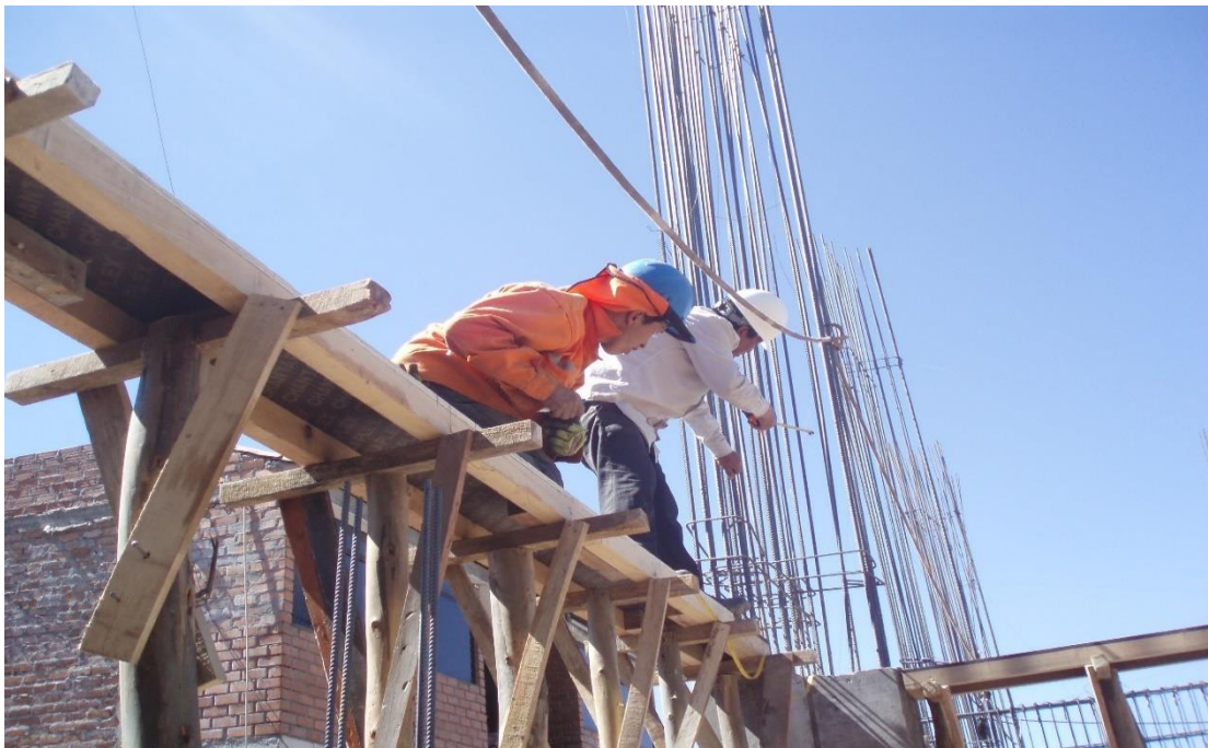
FOTO 03: PERSONAL NEGLIGENTE SIN ARNÉS, MAESTRO DE OBRA Y EL OPERARIO.
