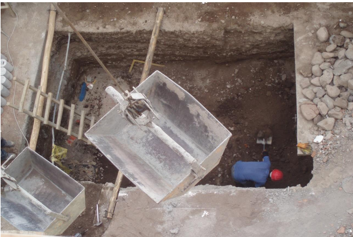
FOTO 9: ALTO RIESGO, BAJO LA CUBETA DE LA WINCHE ELÉCTRICA. REALIZANDO ESCAVACIÓN DE ZANJA SIN CINTA DE PELIGRO.
