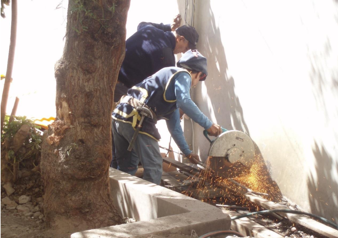
FOTO 06: NEGLIGENCIA DEL PERSONAL, CORTANDO ACERO SIN GUANTES NI GAFAS.
