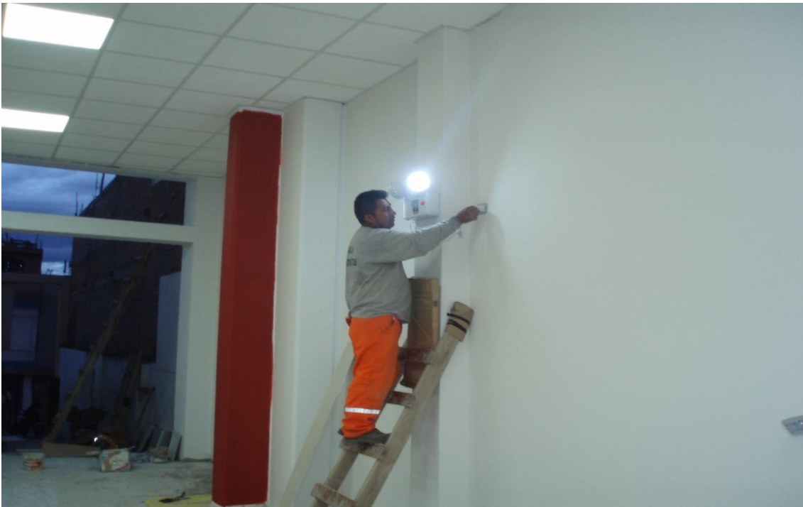
FOTO 07: USO INCORRETO DE ESCALERA Y SIN PRENDA DE PROTECCIÓN, ELECTRECISTA.
