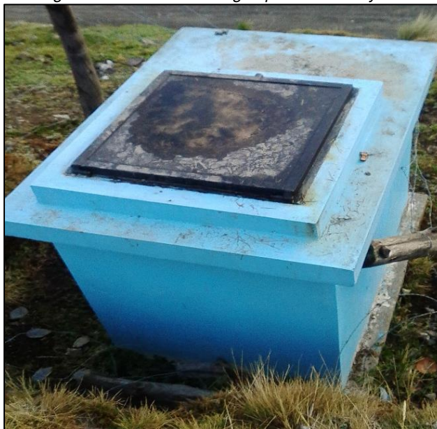
Fotografía 1:Reservorio de agua potable en Soyllullo
