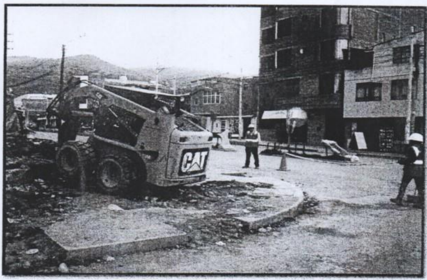
Supervisión permanente por parte del PDR en pleno trabajo de perforación de concreto en la entrada principal del Colegio Santa Isabel.
