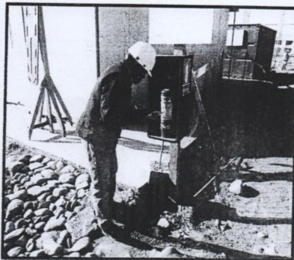
Inspección de extintor por el PDR a cargo de Máximo Quilca Solano
